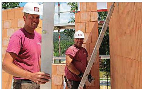
Die Arbeit der Maurer auf der Baustelle machen die Redbloc-Wände deutlich einfacher: Die Handwerker müssen zum Beispiel weniger heben, sich weniger bücken. „Das ist ein wichtiger Punkt, gerade für die Gesundheit der Mitarbeiter auf den Baustellen“, betont Werkleiter Kriegl.
